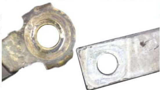
Рис. 1: Подключение заземления до очистки: слабый контакт
