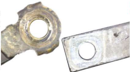
Рис. 1: Подключение заземления до очистки: слабый контакт
